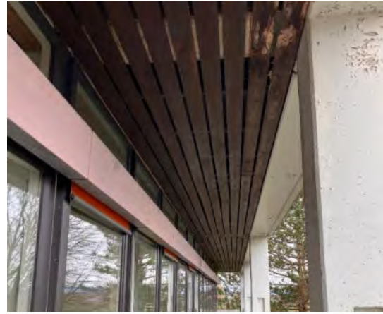
Abbildung 11 Potenzielle Quartiersstrukturen für Fledermäuse an den Rollladenkästen und die Verkleidung der Laufgänge, Foto: W+G 2023.
